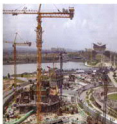
马来西亚布城商业中心 地下室 防水面积：40000m 2 使用材料：PNC401
