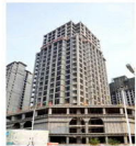
山西临汾市玉秀湾商业及住宅小区 地下室、车库 浇筑量: 33000m 3 (一级防水)
