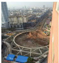
云南玉溪红塔区平战结合人防工程 地下室 浇筑量: 50000m 3 (一级防水)
